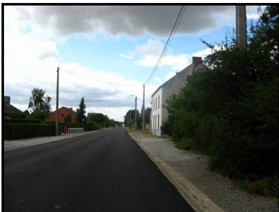
Figure 429 : Photographie du trottoir en gravier et encombré par une haie mal entretenue dans la rue de Pontauray
